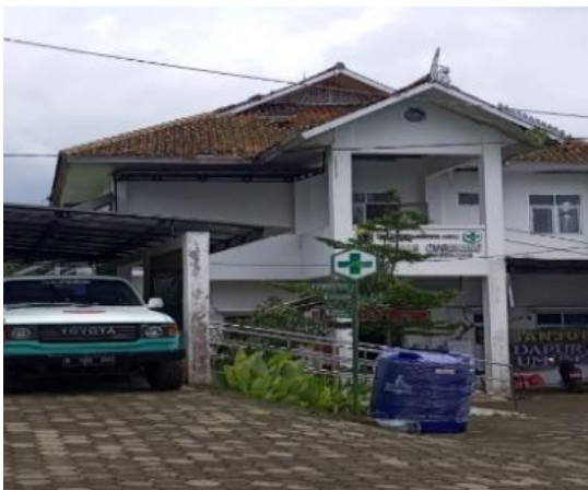
Gambar 2. Kerusakan Pada Genting Puskesmas Cugenang
