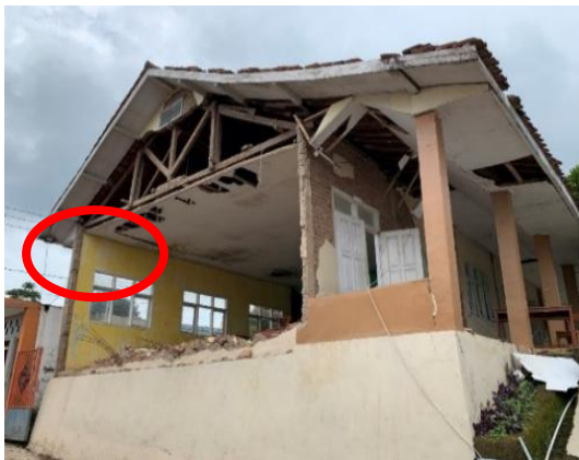
Gambar 6. Dinding Runtuh dan Kolom yang Patah di SMKN 1 Cugenang
