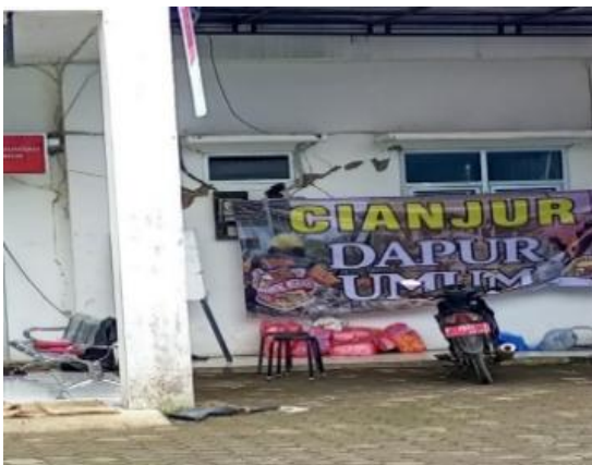
Gambar 3. Kerusakan Pada Plesteran yang Mengelupas di Puskesmas Cugenang
