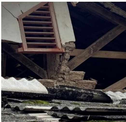
Gambar 7 Kerusakan pada Pertemuan Balok dan Kolom SMKN 1 Cugenang
