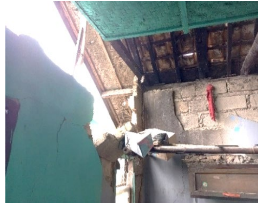
Gambar 4. Dinding Rumah Mengalami Keruntuhan di Desa Benjot
