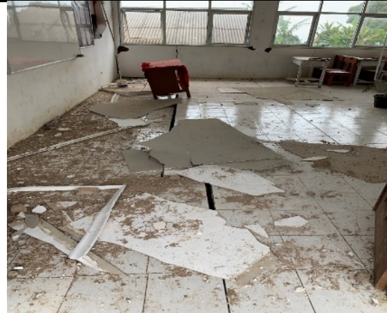
Gambar 8. Kerusakan Pada Lantai di SMKN 1 Cugenang
