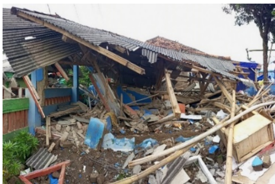
Gambar 7. Rumah Semi Permanen Mengalami Keruntuhan Struktur di Desa Cijedil Sumber : Dokumentasi Pribadi
