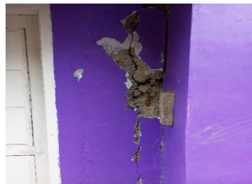
Gambar 2. Retakan Ringan pada Dinding Rumah di Desa Benjot
