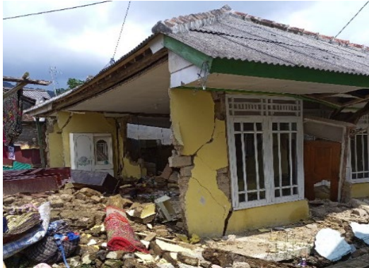
Gambar 6. Rumah Permanen Mengalami Keruntuhan Dinding di Desa Benjot Sumber : Dokumentasi Pribadi
