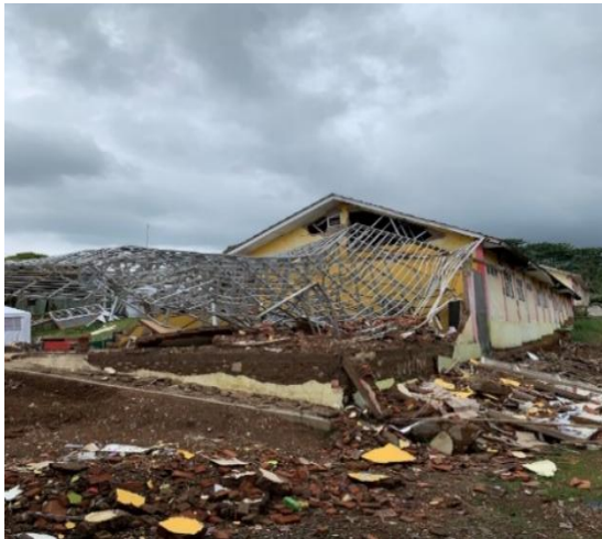
Gambar 9. Runtuh Pada Rangka Atap dan Bangunan SMKN 1 Cugenang
