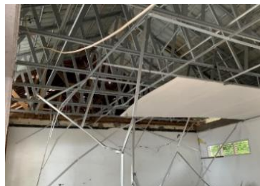
Gambar 4. Rangka Atap & Instalasi Listrik Rusak di SMKN 1 Cugenang
