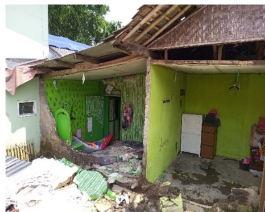
Gambar 5. Rumah Semi Permanen Mengalami Keruntuhan Dinding di Desa Benjot
