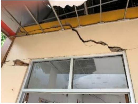
Gambar 5. Retakan Besar Pada Dinding SMKN 1 Cugenang
