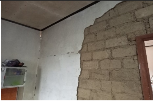
Gambar 3. Plester Dinding yang Terkelupas di Desa Benjot
